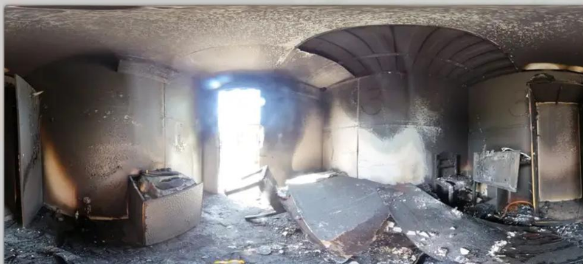
Obrázek 3 Prostor buňky před zapálením a po požáru
