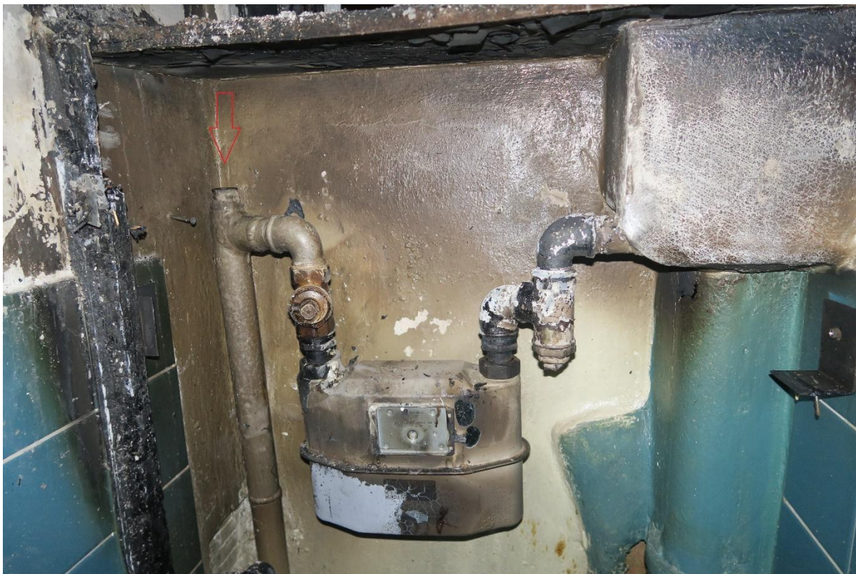
Obrázek 9 dokumentace chybějící zátky plynového potrubí (Zdroj: HZS ČR)
