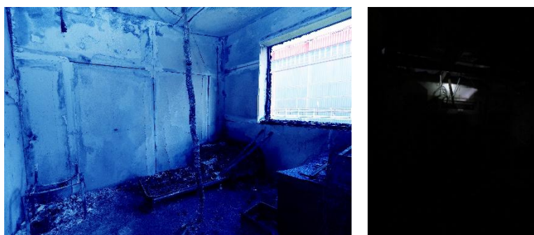
Obrázek 11 Nedostatečné osvětlení prostoru (Zdroj: HZS ČR)
