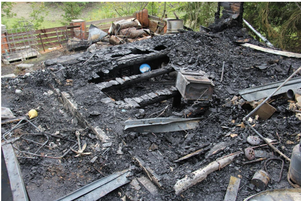
Obrázek 6 Požářiště dřevěné chaty – absence stavebních konstrukcí znemožňuje přesně lokalizovat místo vzniku požáru, proto uvažujeme jako oblast vzniku požáru celý půdorys objektu. (Zdroj: HZS ČR)
